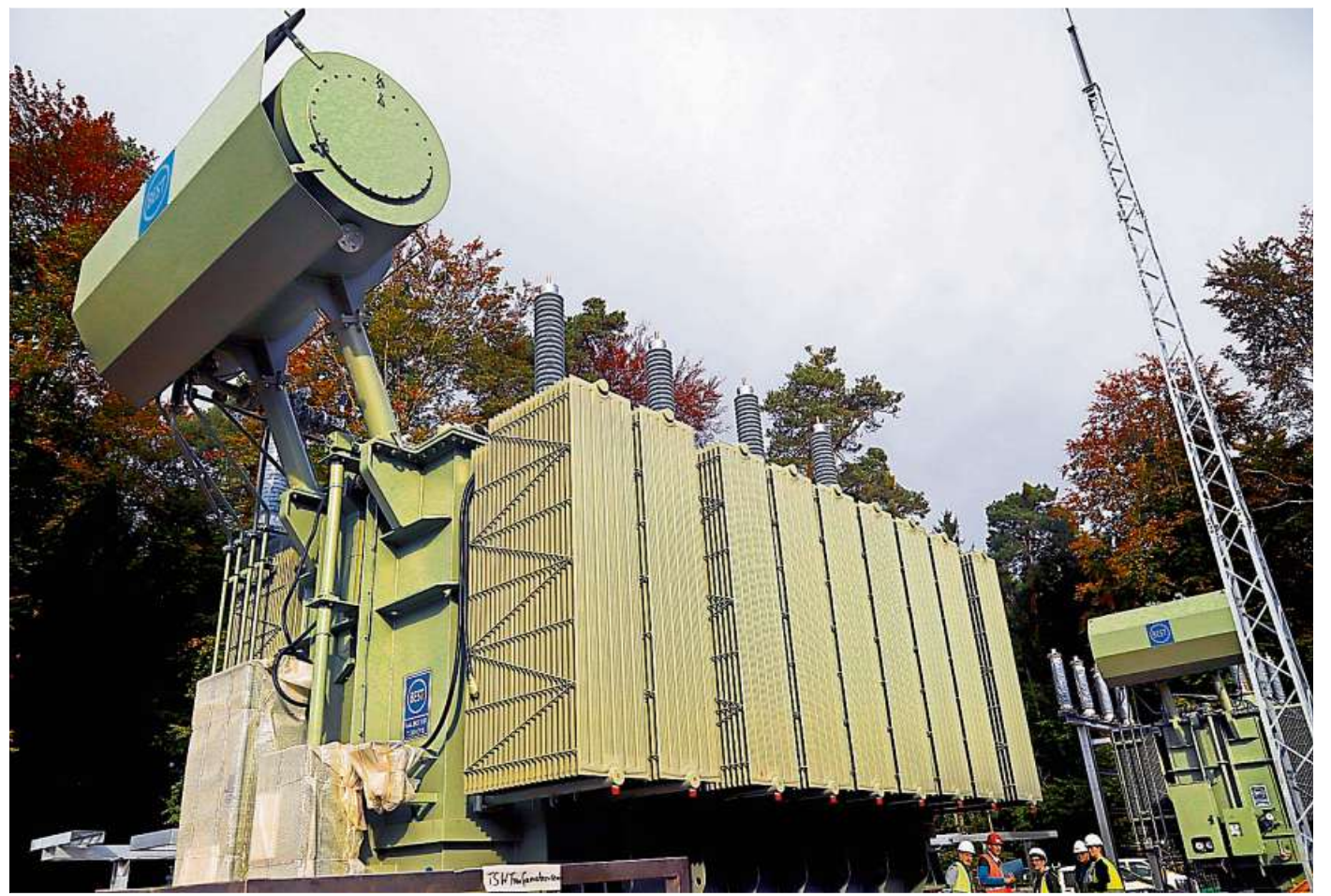
114 Tonnen schwer sind die Transformatoren, die im Osten hinter dem GSI-Helmholtzzentrum derzeit installiert werden. Foto: Andreas Kelm
